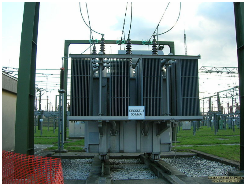
Cuộn cảm lõi sắt 3 pha 50 MVAR trong truyền tải điện tại Đức
