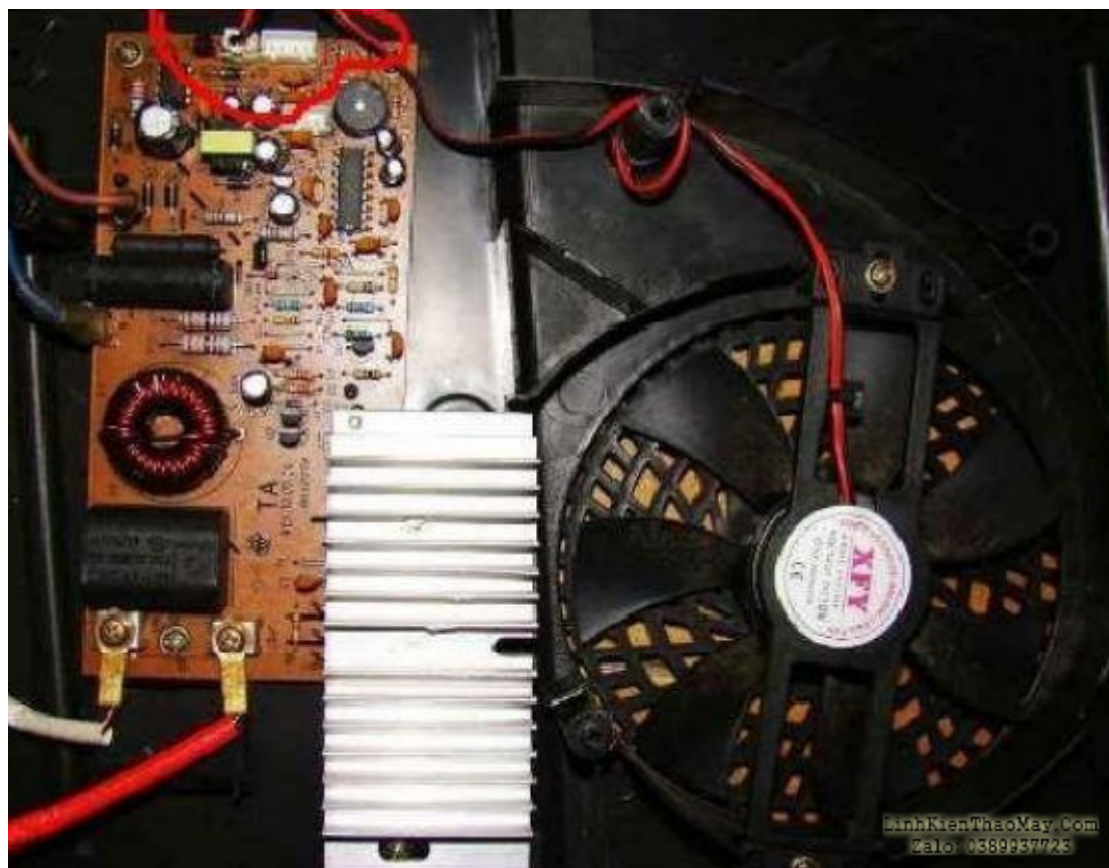
Hình 67. Quạt điện trên bếp từ
