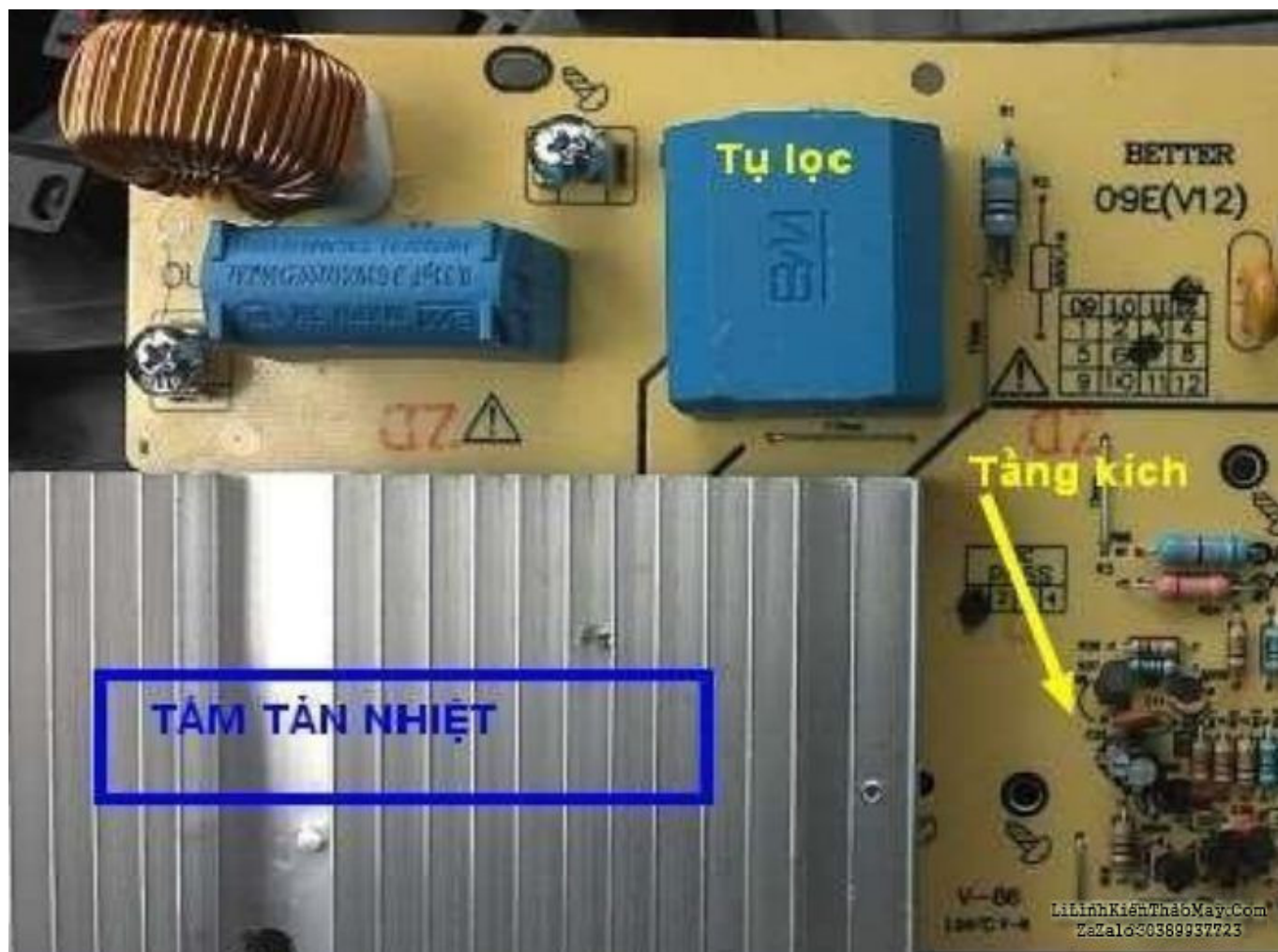
Hình 41. Nhận biết khối công suất tron bếp từ
